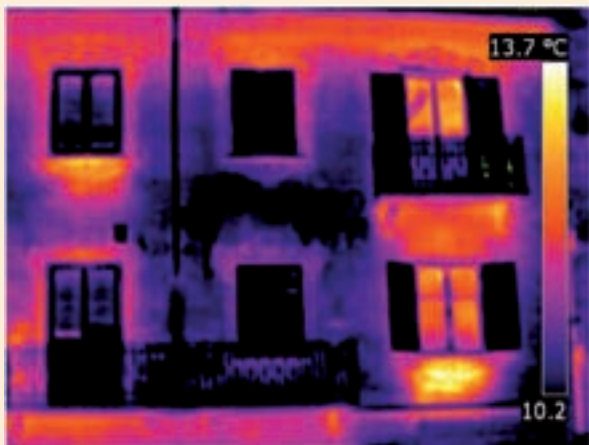
Dispersioni termiche sotto finestra e volini
